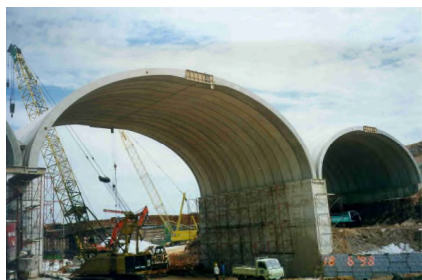
La campata prefabbricata e coperta più grande del mondo, un E84T BEBO in fase di costruzione a Putrajaya, Malaysia.
